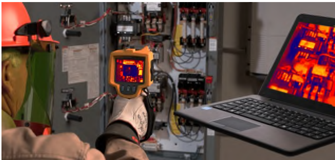
Рисунок 20. Пример проведения тепловизионного контроля электрошкафа
