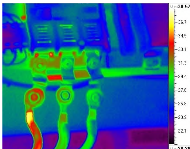
Рисунок 21. Пример термограммы контактных соединений с температурной шкалой
